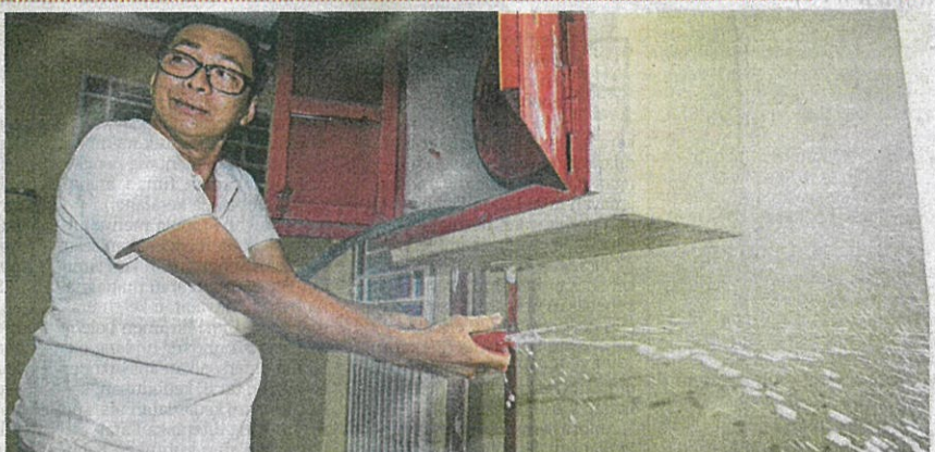
Azhar menunjukkan hos pancuran basah yang kurang tekanan air selepas setahun kejadian kebakaran kediamannya di tingkat 14 Perumahan Awam Seri Kelantan, Sentul pada Julai 2016.
