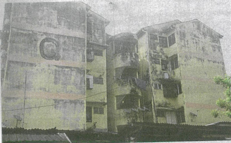
Sebahagian blok bangunan Flet Keramat Permai yang berada dalam kedaifan.
