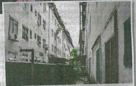
Bukan sahaja masalah bumbung, penduduk flat Taman Kem juga terpaksa berdepan dengan masalah kebersihan seperti saliran dan kemudahan yang tidak sempurna.
