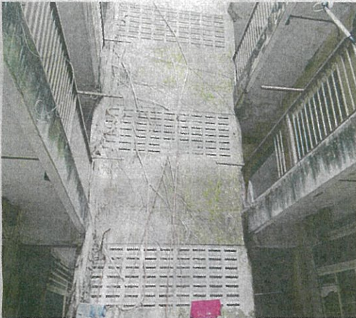
Kelihatan akar pokok melingkar di dinding bangunan.
