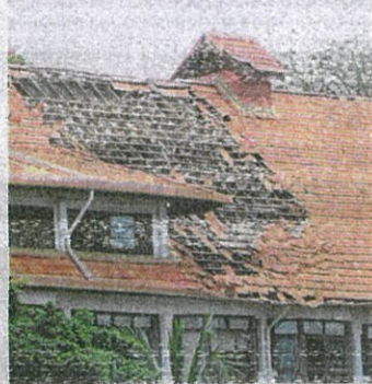
Siling bumbung bilik di Hotel Avillion Port Dickson yang runtuh, malam kelmarin.
