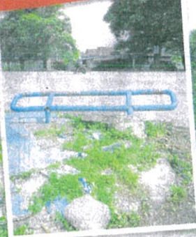
PENGHADANG keselamatan yang rosak seperti ini membahayakan pengguna jalan raya.
