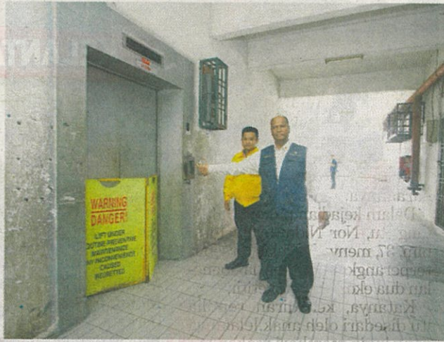
PONNAMPALAM menunjukkan lif yang rosak di Flat Megah Kepong, Segambut semalam.
