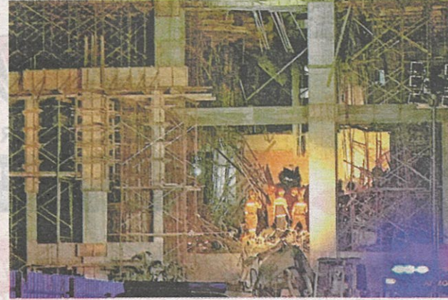
BANGUNAN empat tingkat Pencawang Masuk Utama TNB di Jalan Cochrane yang runtuh dan mengorbankan seorang pekerjanya.
