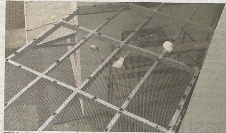
TERDAPAT sampah terperangkap pada jaring keselamatan yang tidak sampai seminggu dipasang DBKL dalam tinjauan di PPR Sri Pantai, Kuala Lumpur baru-baru ini.
