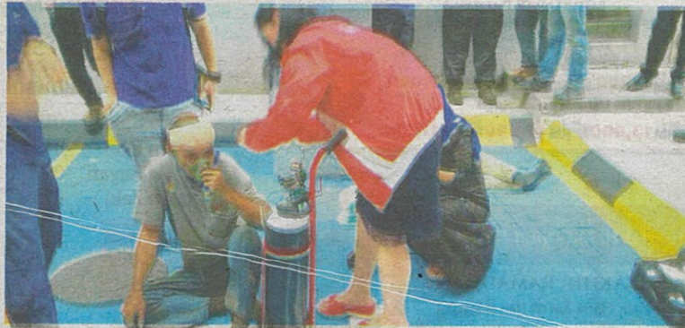
SEORANG daripada tiga pekerja yang sesak nafas akibat terhidu gas CO 2 mengalami kecederaan pada kepala akibat terjatuh di dalam bilik substesen sebuah bank di Jalan Sultan Ismail, Kuala Lumpur semalam.
