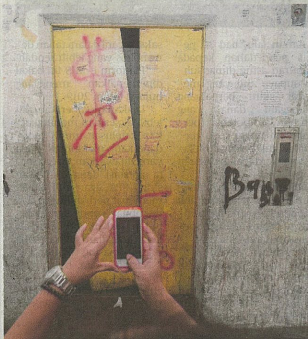
KEADAAN lif yang rosak sehingga memberi tekanan kepada penduduk di Pangsapuri Taman Permai Indah, Pandamaran.
