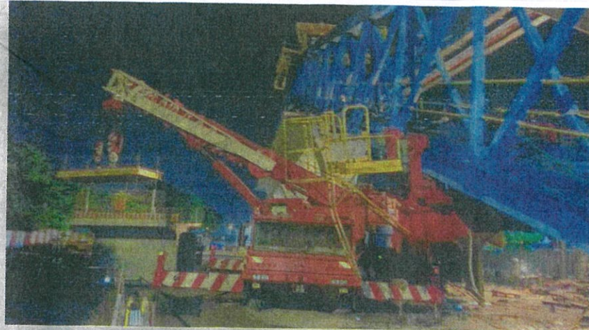
KEADAAN gelangsar gantri yang jatuh dan mengorbankan seorang pekerja di tapak pembinaan Jalan Jinjang, Kuala Lumpur, semalam. - IHSAN BOMBA
