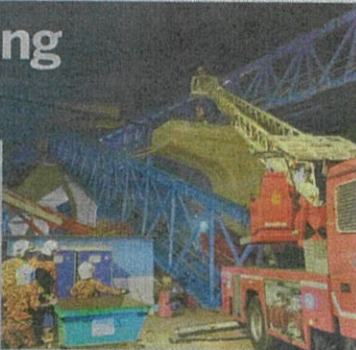
INILAH kren sepanjang 96 meter yang tumbang dan menyebabkan seorang pekerja maut di tapak pembinaan MRT, Jalan Jinjang, Kuala Lumpur malam kelmarin.
