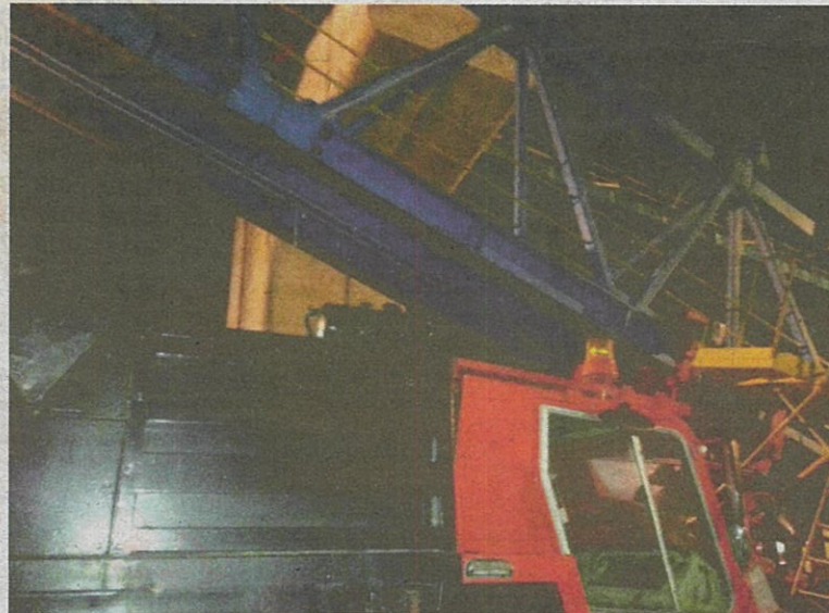
KEADAAN gelangsar gantri yang tumbang sehingga menyebabkan seorang maut di tapak pembinaan MRT di Jalan Jinjang, Kuala Lumpur kelmarin.
