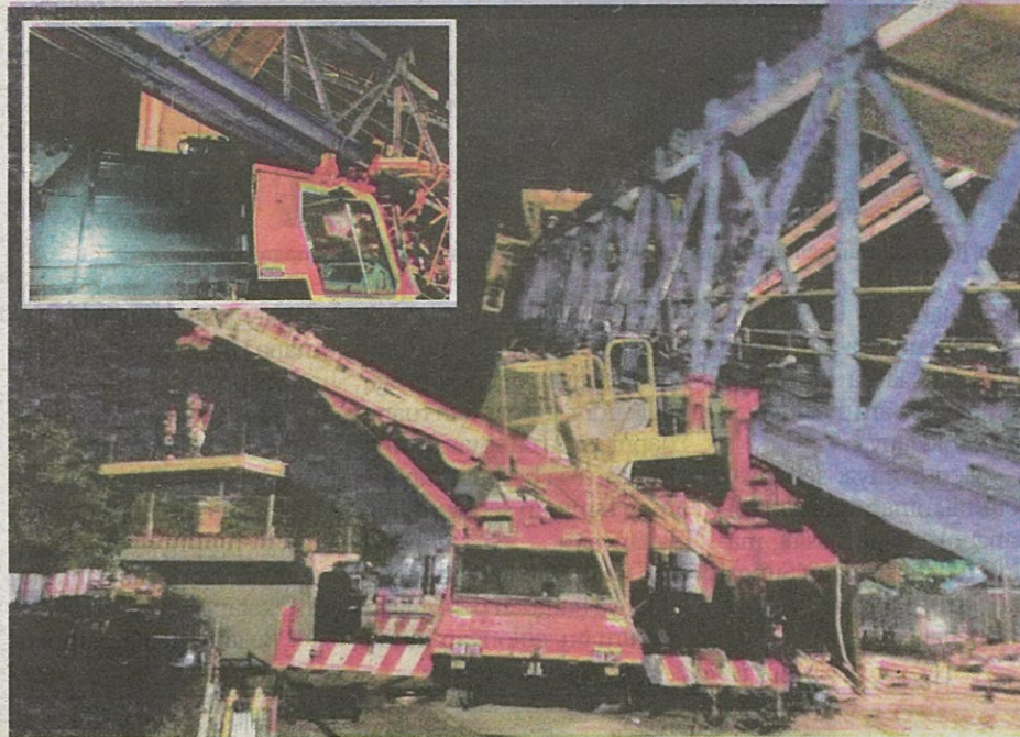
Kren 'launching girder' tumbang di tapak pembinaan MRT berhadapan Balai Bomba dan Penyelamat Jinjang.
