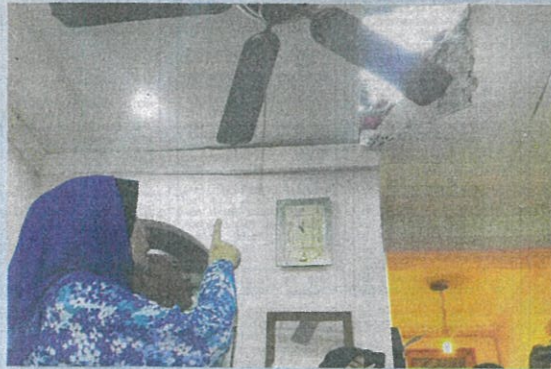
HALIMATON SAADIAH BOHAN menunjukkan bumbung rumah penghuni yang rosak selepas dipukul ribut semasa lawatan ke Flat Gugusan Semarak, Seksyen 4, Kota Damansara, Petaling Jaya, Selangor, baru-baru ini.
