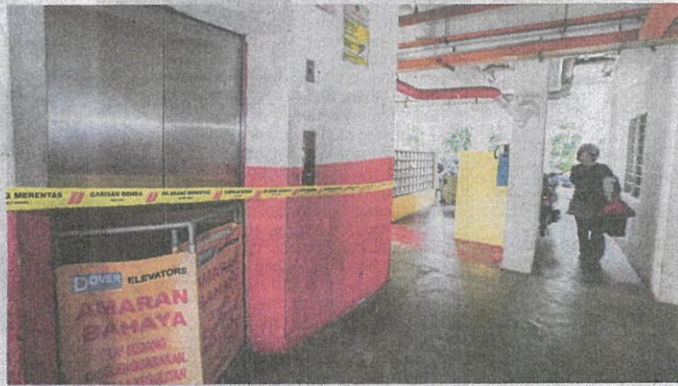
Lif yang rosak selepas terhempas dari tingkat lima di Blok C, PPR Kerinchi, Kuala Lumpur masih belum boleh digunakan penduduk.
