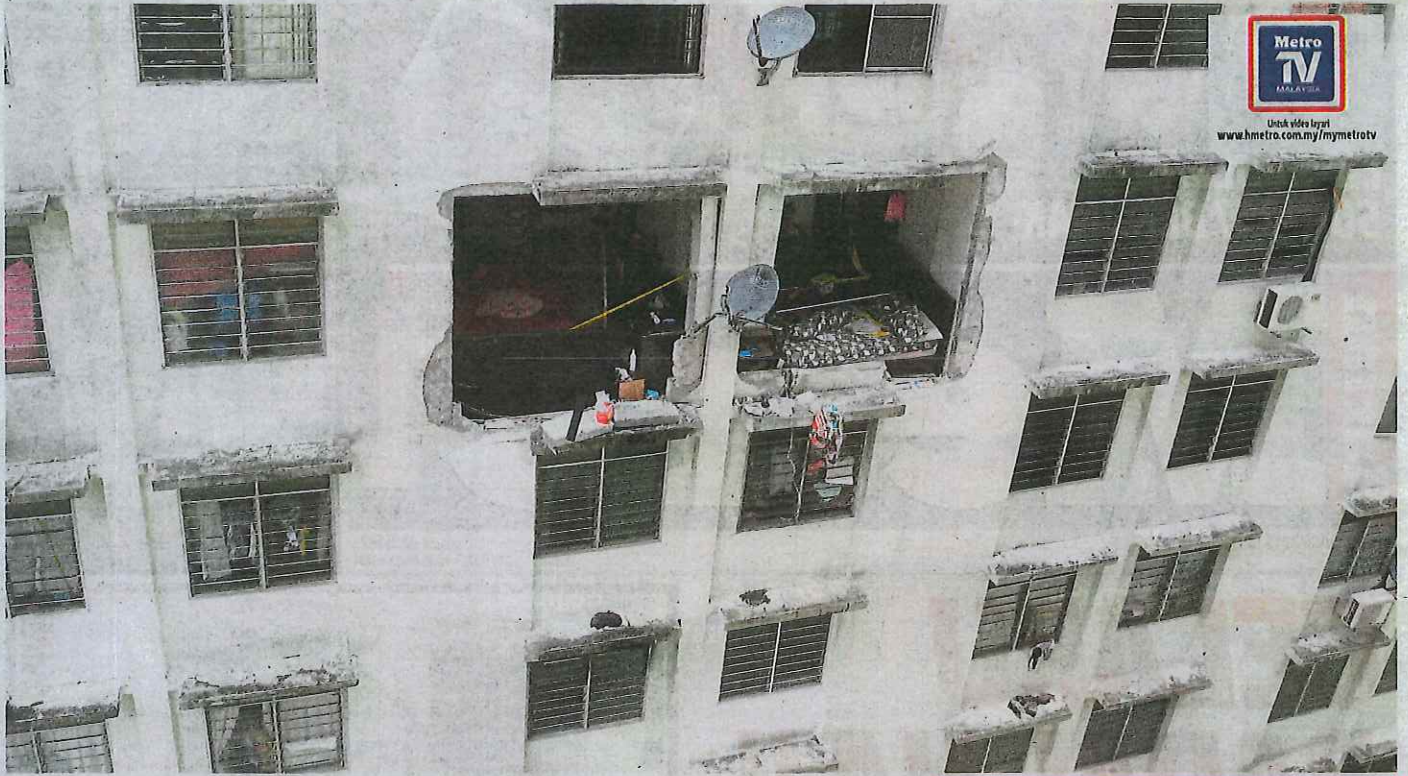
KEADAAN dinding unit pangsapuri tingkat 20 di Jalan Paya Terubong selepas berlaku letupan.
