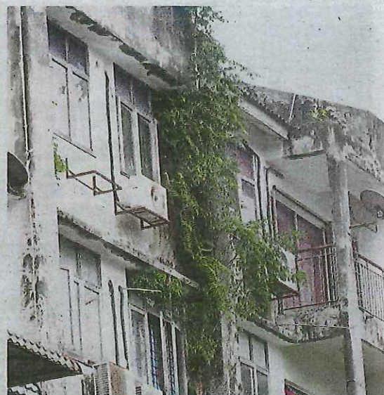
Pokok tumbuh di dinding bangunan menyebabkan air masuk apabila hujan.
