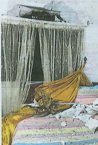
DINDING rumah penduduk yang rosak.
