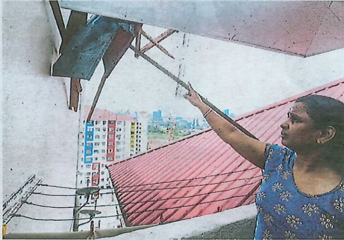
THAVAMALAR menunjukkan bumbungnya yang rosak akibat ribut.
